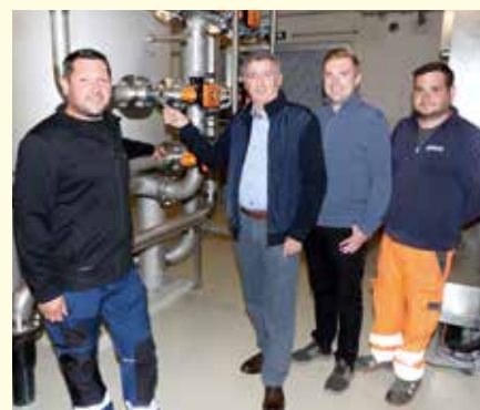
Inbetriebnahme durch Bgm. Günter Müller, Bmstr. Ing. Harald Gruböck, Gemeindevorarbeiter Gerhard Postl und Gemeindefahrer Patrick Lind.
