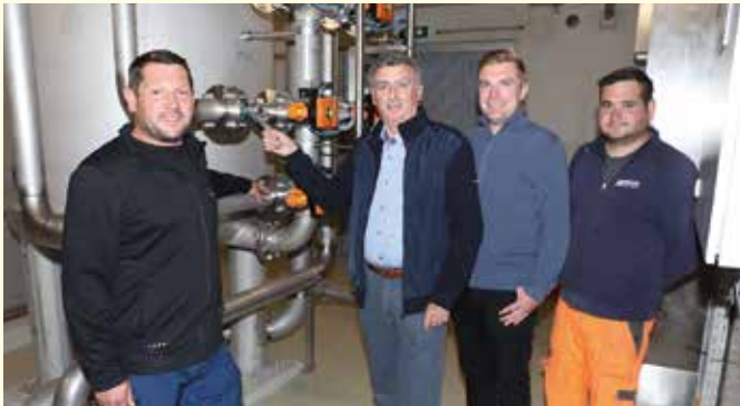
Eine zusätzliche Wasseraufbereitungsanlage mit einer 70 kWp Photovoltaikanlage sowie Speicher und Notstromversorgung wurde in Betrieb genommen.
