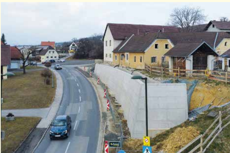
Die neu errichtete Stützmauer beim Anwesen der Familie Teubl fügt sich funktional in die Umgebung ein.
