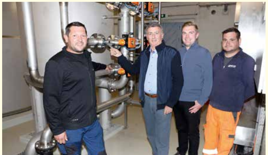
Inbetriebnahme durch Bgm. Günter Müller, Bmstr. Ing. Harald Gruböck, Gemeindevorarbeiter Gerhard Postl und Gemeindearbeiter Patrick Lind.
