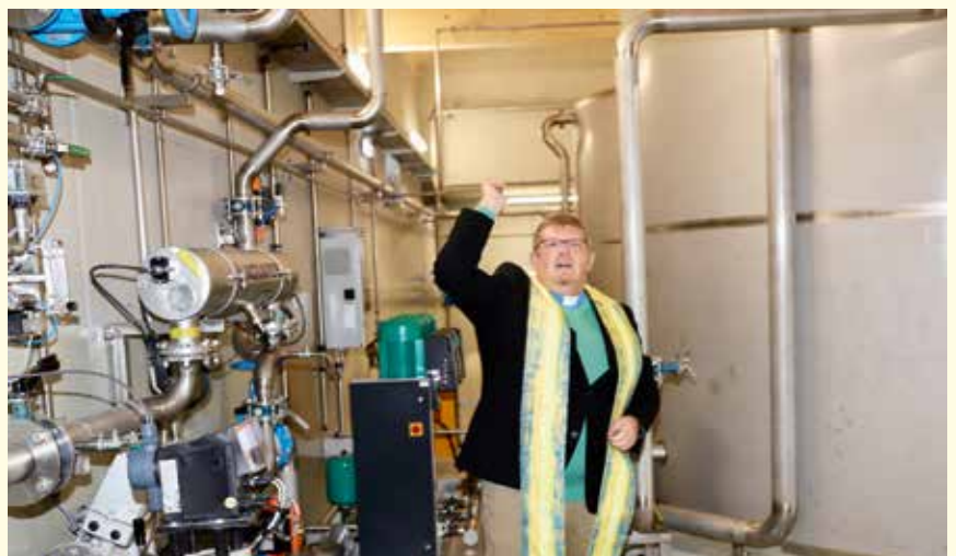
Vikar Mag. Mario Brandstätter segnete die neue Wasseraufbereitungsanlage.
