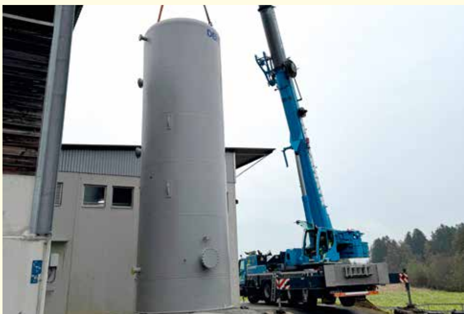
Der neue Pufferspeicher, mit einer Höhe von über 12 m, hat ein Fassungsvermögen von 100.000 Liter.
